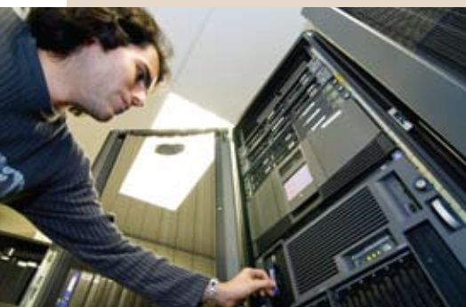
RACK de comunicacions RACK de comunicaciones
