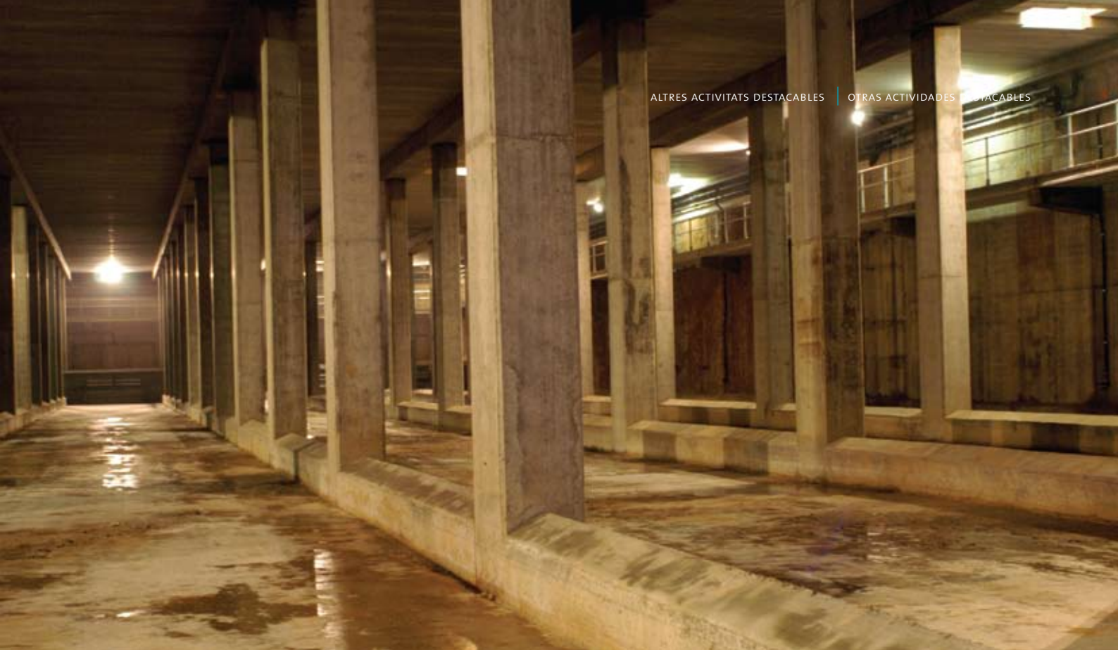
Dipòsit de retenció d'aigües pluvials de Vilalba dels Arcs | Depósito de retención de aguas pluviales de Vilalba dels Arcs
