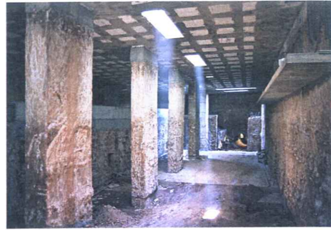
Arriba, ejecución bajo cubierta en el depósito de Doctors Dolsa. Debajo, a la izquierda, ejecución de una pila-pilote en el depósito 'Joan Miró'.
