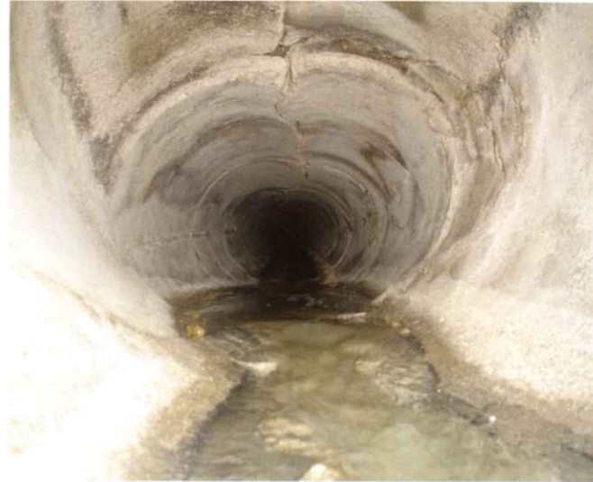
Tramo de tubo de hormigón en rotura
